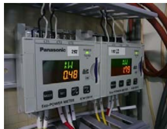
照明やエアコンの消費電力を計測しています
