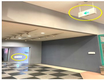
実際に館内の誘導灯で説明を受けました
